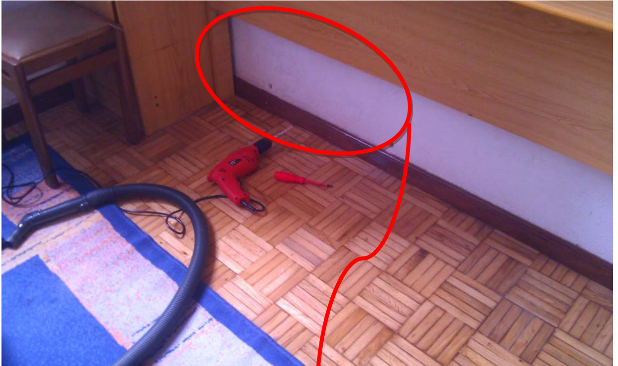
Zona en la que hay moho
